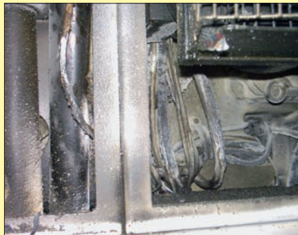
Durch Brand verkohlte Maschinenbauteile könnten fachmännisch repariert werden.
